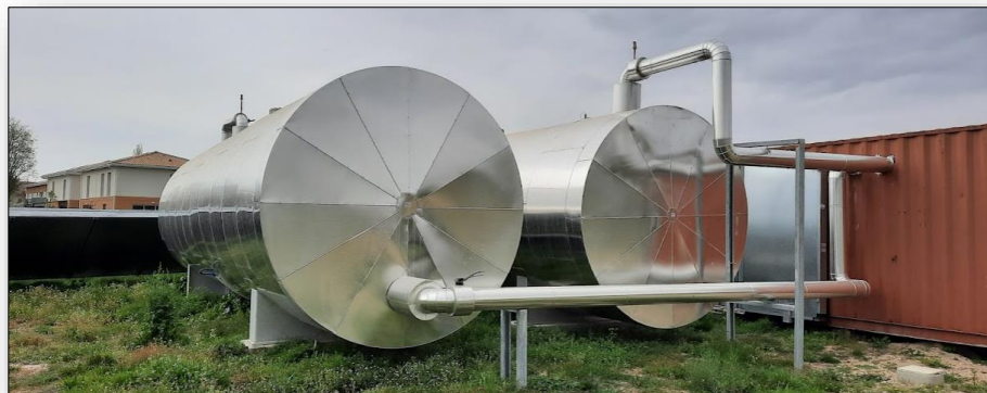
Les cuves de stockage journalier, 50 m 3 , juste devant les 8 rangées de panneaux solaires. au fond les maisons du lotissement chauffées par ce dispositif (photo CE)
