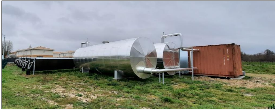
Sur la gauche les panneaux solaires – les cuves de stockage journalier et le local technique Au fond, le lotissement du Moulin, bénéficiaire de ce projet technologique (photo CE)
